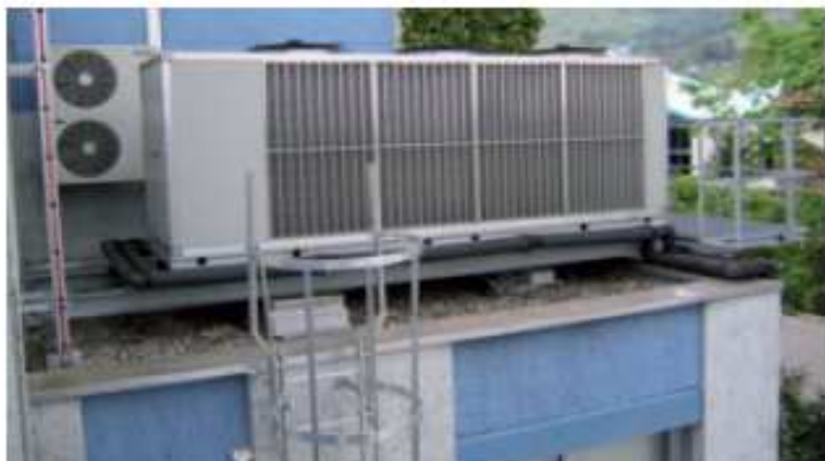
Изоляция системы кондиционирования
