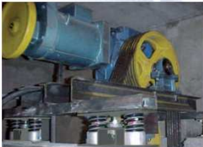
Виброизоляция привода лифта
